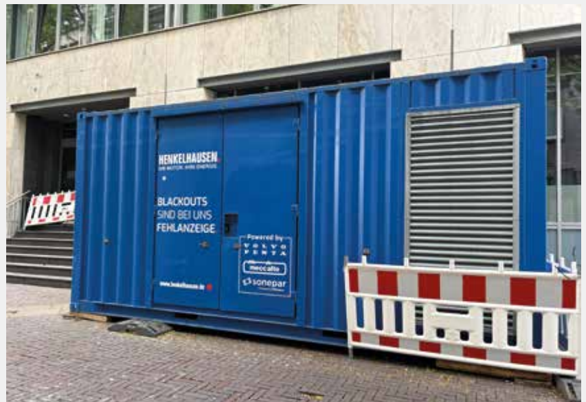
Für temporäre Einsätze, wie hier in der Essener Innenstadt, stehen Leihaggregate zur Verfügung.
